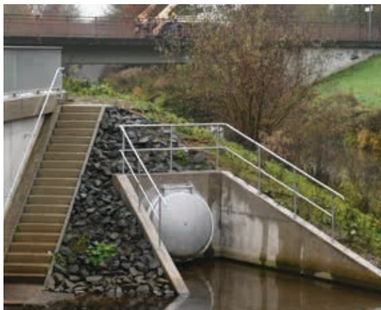
Über eine Sammeldruckrohrleitung wird das Wasser vom Mühlgraben in die Unstrut geleitet.
