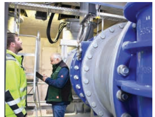
Abwassermeister Thomas Nolte (l.) im Gespräch mit Jörg Schwarz von der DEKRA im Untergeschoss des Schöpfwerk-Gebäudes. Im Hintergrund sind die Steigrohre mit den Spitzenlastpumpen zu sehen, die jeweils eine abgehende Druckrohrleitung (Vordergrund) beschicken.
