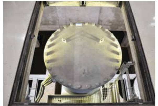
Blick von oben durch die Revisionsöffnung im Erdgeschoss auf das Steigrohr, indem eine Spitzenlastpumpe untergebracht ist.
